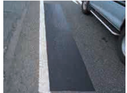
クラック補修
